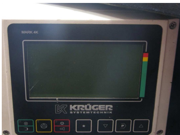
Panel kontrolny w kabinie operatora
