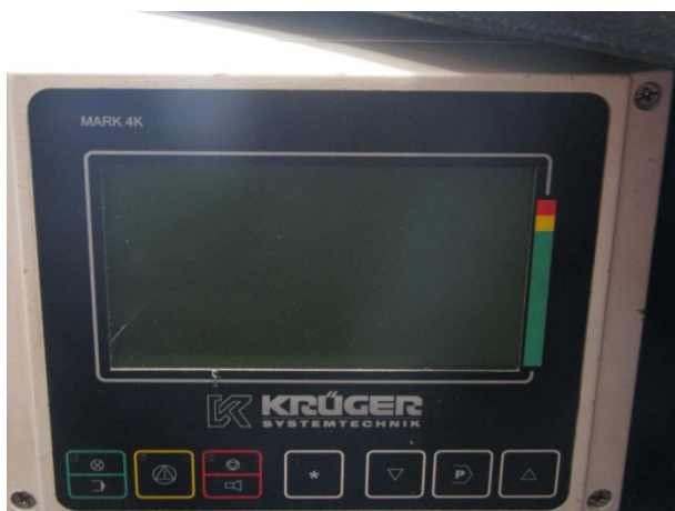
Panel kontrolny w kabinie operatora
